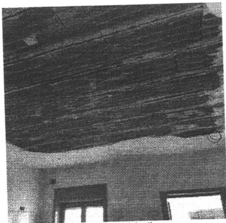
Sfondellamento solaio di copertura
